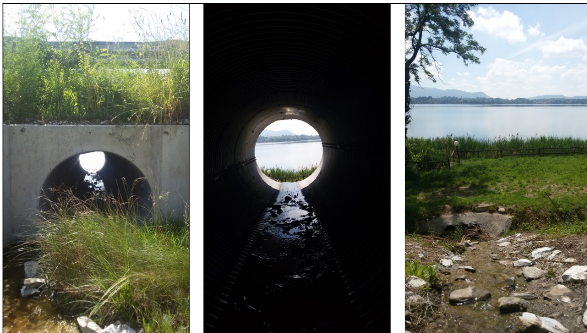
Figura 10 – Il tunnel n.2 (ingresso nord, l'interno e l'uscita a sud verso lago)
